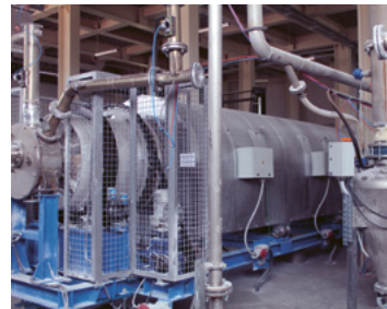
Kalzinieranlage in Zvornik
